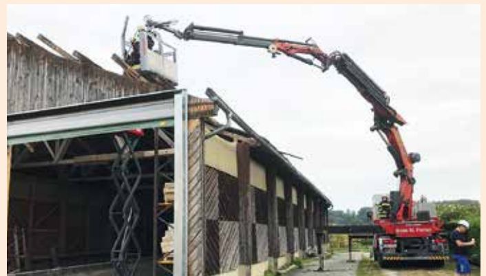
Abgedecktes Dach bei einem Wirtschaftsgebäude in der Katastralgemeinde Lebing
