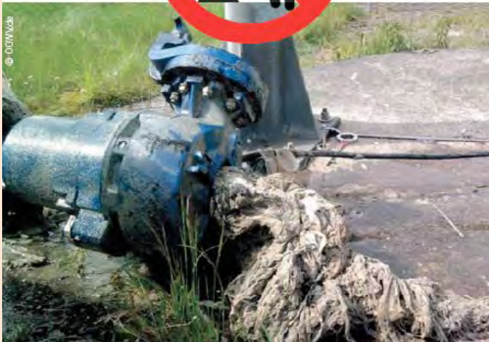
Feuchttücher verstopfen unseren Kanal
