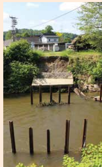
Das eingestürzte Widerlager verursacht eine Projektänderung
