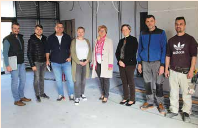
v. l. n. r.: Ing. Michael Marx, Ing. DI (FH) Moritz Purr, Ing. Joachim Powoden, Cafébetreiberin Susanne Riederer, Vzbgm. Maria Kögl, Mag. Sabine Zenz und zwei Mitarbeiter der Firma Powoden bei der Baustellenbesichtigung im neuen „Café Liebling“ (Foto: Marktgemeinde Groß Sankt Florian)
